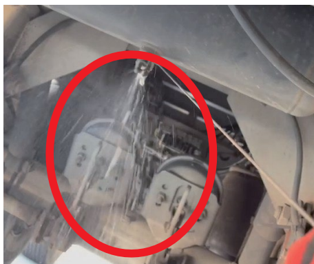
異常(凝水が溜まる)
