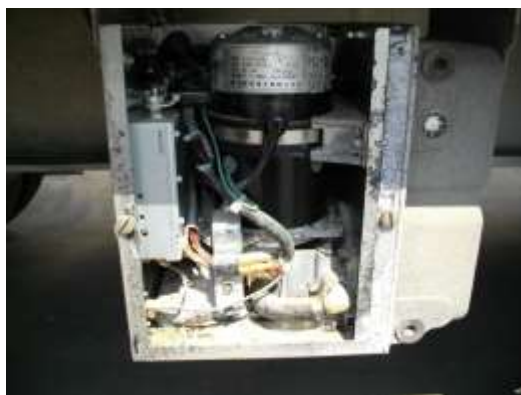
①ユニットのボックス内に冠水し各部が腐食しています。
