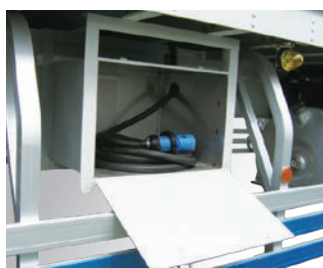
●フェリー用電源ケーブル収納庫
