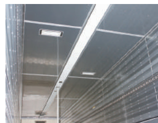
●断熱センタービーム
