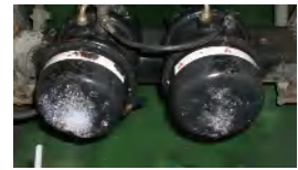
③よりエア漏れの事例
